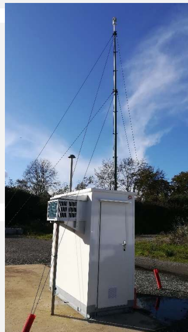
Station pérenne sur le site de traitement
