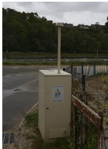
Figure 2 : Cabine installée sur le site du Légué
