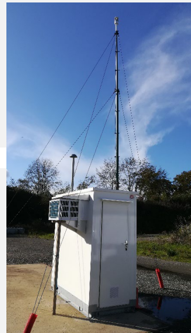
Station pérenne sur le site de traitement
