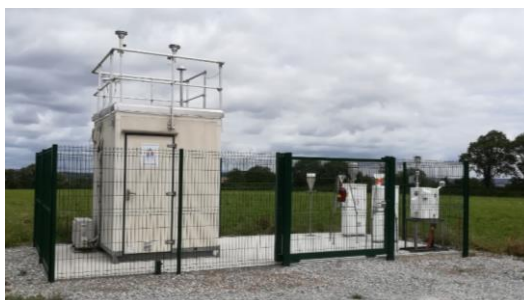
Site de mesures de Kergoff à Merléac
