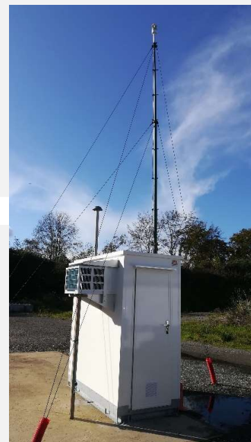
Station pérenne sur le site de traitement
