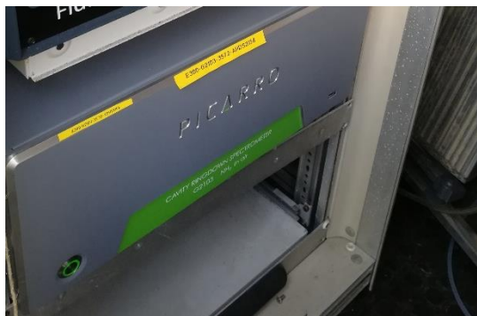
Figure 5 : Analyseur de mesure du NH 3 en continu installé à Kergoff
