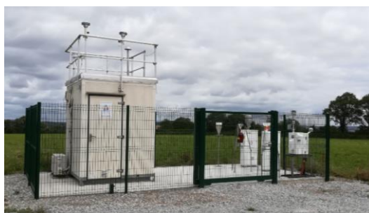
Site de mesures de Kergoff à Merléac (22)
