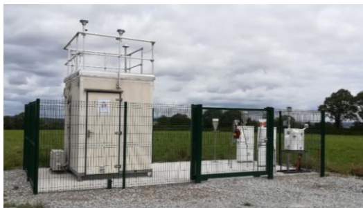
Site de mesures de Kergoff à Merléac
