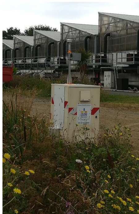
Analyseur automatique d'hydrogène sulfuré mis en place sur le site
