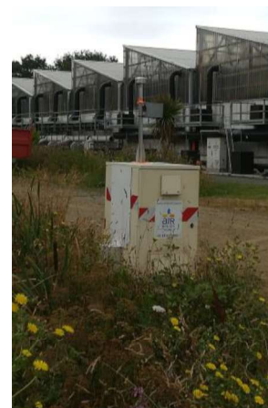
Figure 2 : Cabine contenant l'analyseur H 2 S
