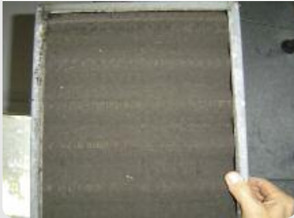
Photo 15 : Filtre de CTA très encrassé
