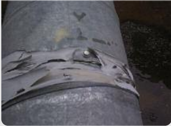
Photo 6 : Adhésifs détériorés sur conduits extérieurs
