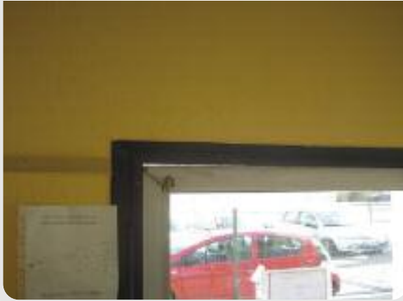
Photo 14 : Porte-fenêtre non étanche à l'air (jour visible)
