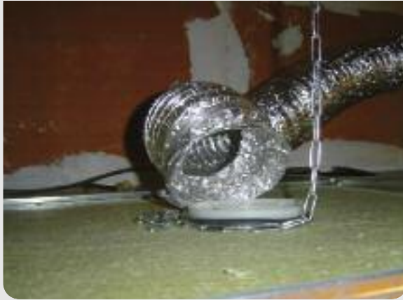
Photo 12 : Bouche déconnectée au-dessus du plafond
