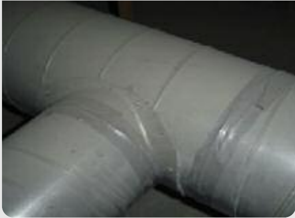
Photo 5 : Conduits étanches en combles
