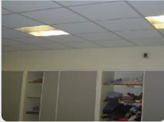
Photo 13 : Bouches d'extraction d'air dans un dortoir
