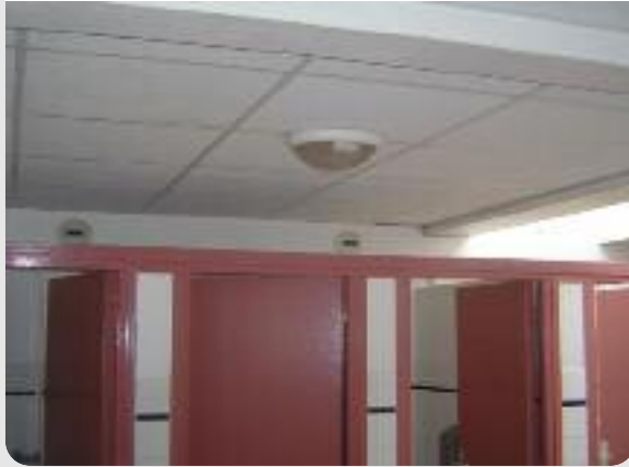
Photo 11 : Bouches d'extraction dans des sanitaires
