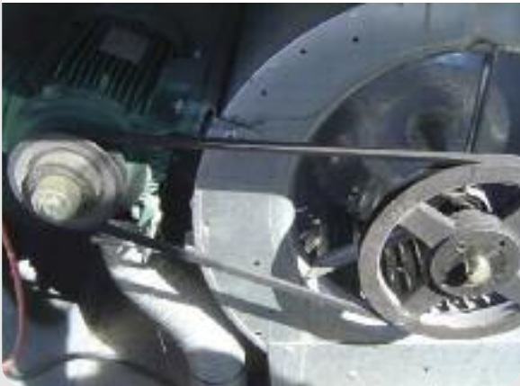
Photo 2 : Courroie ventilateur en bon état
