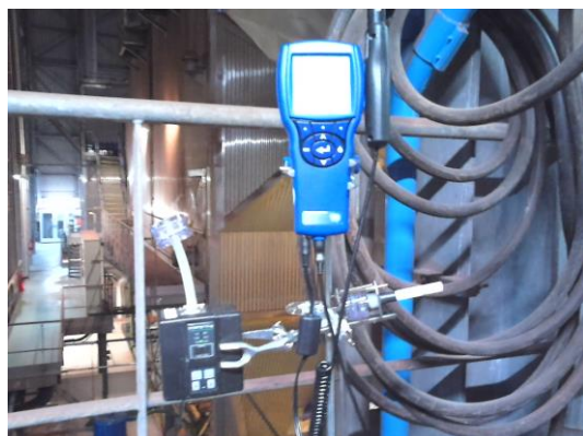
Figure 3 : point de mesure 'Four'
